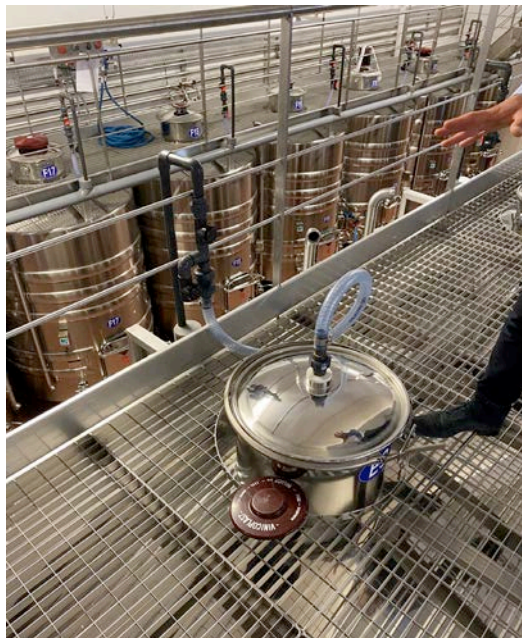
L'évacuation du CO 2 (réseau bleu) au Château Montrose à Saint-Estèphe. Ce nouveau type de cuverie est en cours d'installation au domaine Dujac.
